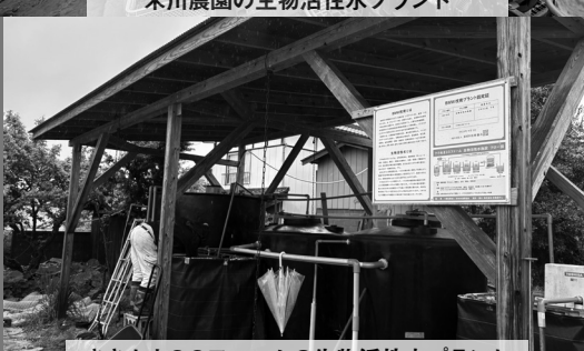
ささめま33ファームの生物活性水プラント
